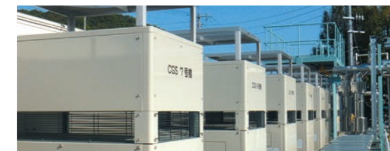
バイオガス発電設備
